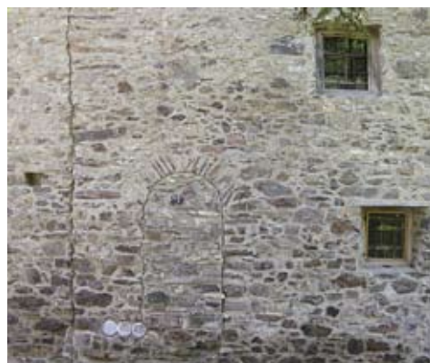
Abb. 151: Luzein, Putz, Haus Nr. 231. Vermauerter Eingang der ersten Bauphase in der Nordfassade.
